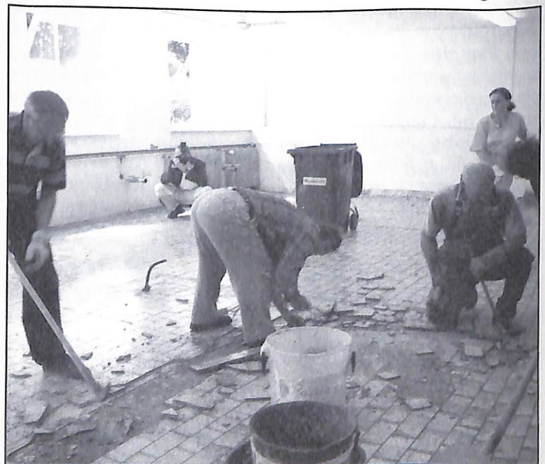
Ein neuer Estrich, teils sogar neue Bodenplatten, für das Untergeschoss der Schule sind notwendig. Nach dem Hochwasser haben freiwillige Helfer den Boden vollständig entfernt. Foto: kk
