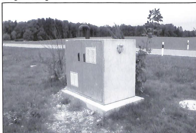
Westerndorf hat bereit seine Kleinkläranlage, die auf 50 Einwohner ausgelegt ist. Foto: kk
