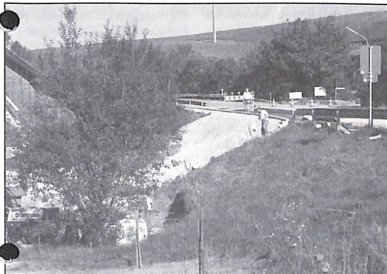
Nach vier Wochen nach den Überschwemmungen konnte die gesperrte Straße nach Oberpfraframmern wieder für den Verkehr frei gegeben werden. Die beschädigte Stelle war ausgebessert. Foto: kk
