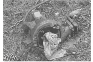
Beispiel für eine verstopfte Pumpe im Kanalnetz:
