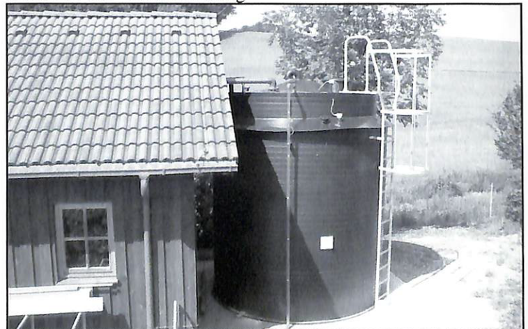
Die neue Phosphatfällanlage (hier der Turm mit dem benötigten Zusatzmittel) arbeitet seit einigen Wochen tadellos. Glonn hatte die vorgegebenen Grenzwerte zuvor deutlich überschritten und eine erhöhte Abgabe bezahlen müssen.
