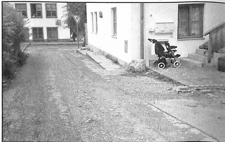
Das namenlose Verbindungsstück zwischen Niedermair- und Feldkirchner Straße ist nach Verlegung der Wasserleitung beschädigt und wird zusammen mit dem Furtmüllerweg noch im Herbst geteert.
