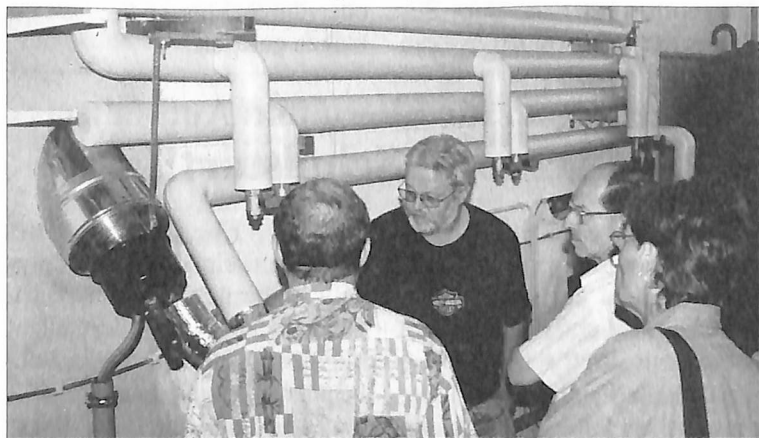
Wirkungsweise und Einsparmöglichkeiten eines Blockheizkraftwerks erläuterte den planende Ingenieur Benedikt Huber den Besuchern. Foto: kk
