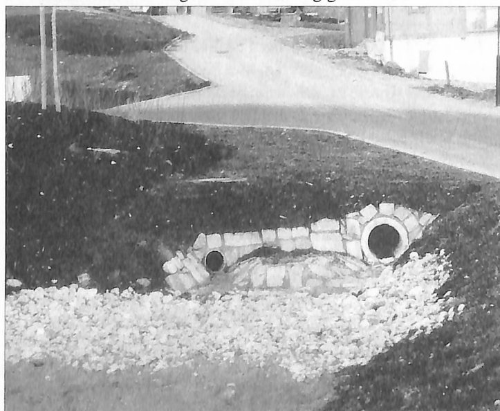
Das Muldensystem wird auch mit heftigen Regenfällen fertig. Hier der Einlauf unterhalb des Penny-Marktes. Foto: kk
