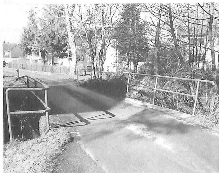
Die Geländer aller Glonner Brücken sind schadhaft. An der Wiesmühlstraße muß außerdem ein Hilfsjoch eingezogen werden, um die Sicherheit vorerst zu gewährleisten.
