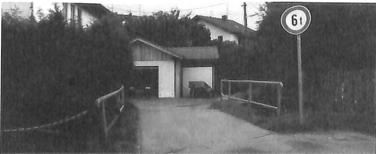
Solche Gewichtsbeschränkungen werden von vielen Lkw-Fahrern höchstens als unverbindliche Empfehlungen betrachtet. Ein Brückenbuch soll jetzt genaueren Aufschluß über den Zustand der Brücken in der Marktgemeinde geben. Foto: kk
