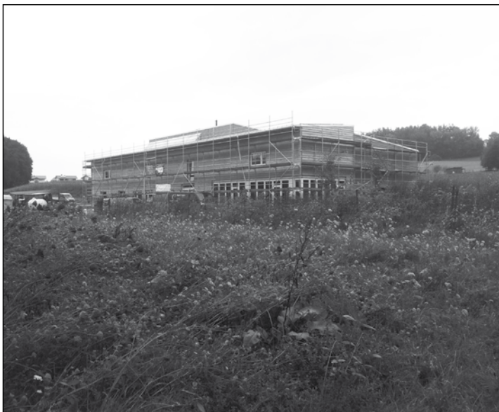
Das Photovoltaikdach des WSV Sportheim.
