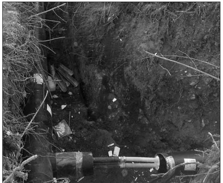
Modernste Isolationstechnik ermöglicht die Wärmeversorgung auch über längere Distanzen. Foto: privat
