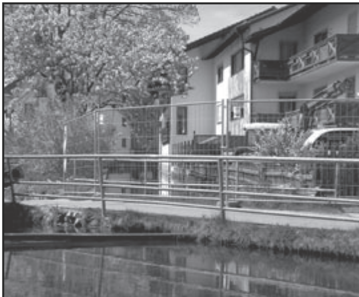
Ein Dauerbrenner im Gemeinderat, die Kupferbachbrücke, soll jetzt erneuert werden, wenn das Wasserwirtschaftsamt eine Zustimmung zur Planung gegeben hat.
