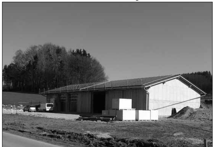
Das Westdach ist mittlerweile komplett mit Photovoltaik ausgestattet, über eine Bestückung des Ostdaches muss noch entschieden werden. Foto: sk
