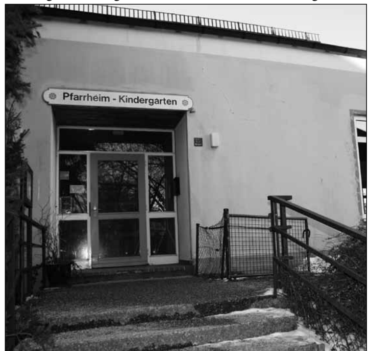
Das alte Pfarrkindergartengebäude ist nicht mehr zu sanieren. Foto: cg
