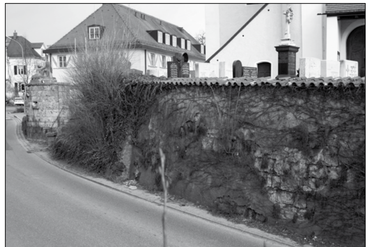
„Immer wieder fallen Steine und Putz von der Friedhofsmauer“, beklagte Franz Kellner sen. Foto: Gerneth
