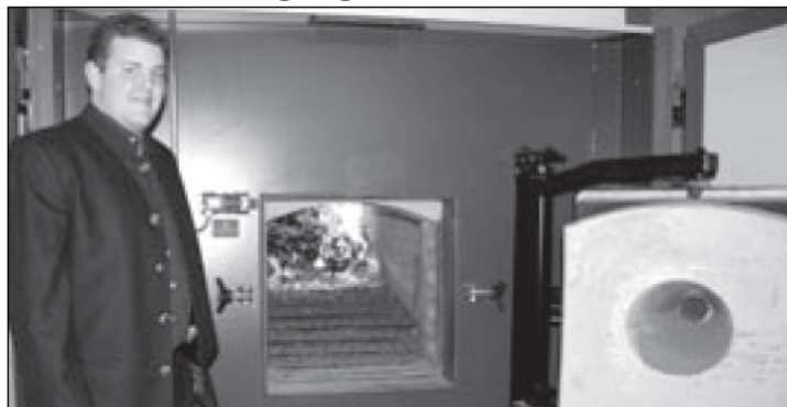
Heizmeister Klaus Niedermair junior sorgt für einen reibungslosen Ablauf im Heizwerk. Foto: Gerneth
