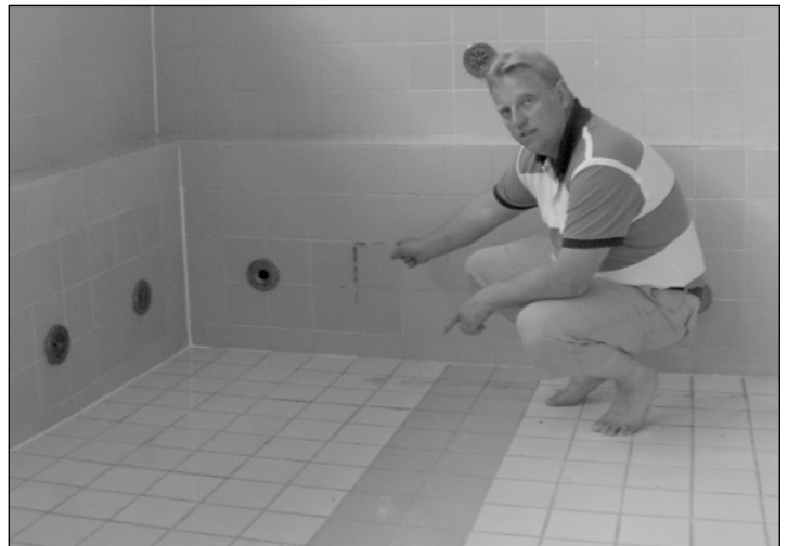
Das Glonner Hallenbad ist schon länger ein Sorgenkind der Gemeinde. Immer wieder sind dringende Sanierungsarbeiten erforderlich, wie unser Archivbild von 2006 zeigt.
