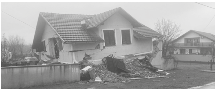
Überall sieht man zerstörte Häuser im Krisengebiet.
