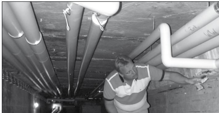
Schon seit langem sind deutliche Erosionsschäden im unteren Umgang des Beckens zu erkennen, wie dieses Foto aus dem Jahr 2006 zeigt, die eine Generalsanierung unumgänglich machen. Foto: sk
