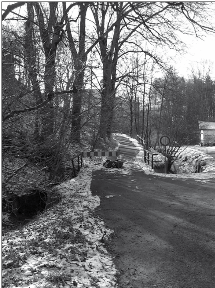
Die Verbindungsstraße zwischen den Ortsteilen Oberdorf und Tal in Haslach ist abgesackt und musste deshalb aus Sicherheitsgründen gesperrt werden. Foto: sk
