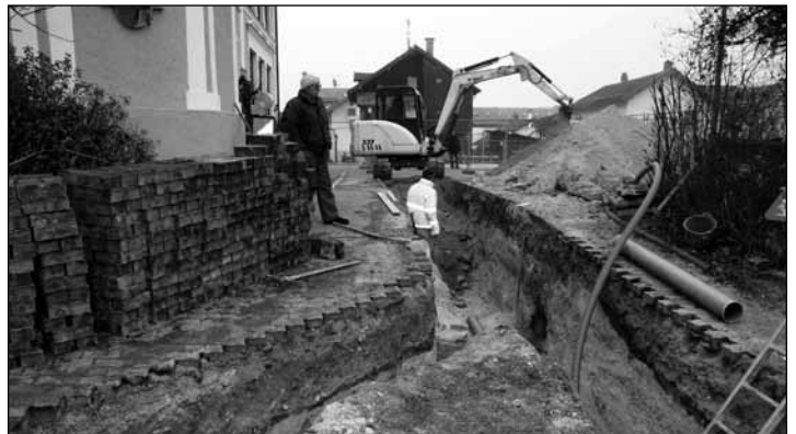
Der Anschluss der ehemaligen Hausmeisterwohnung an die Nahwärmeleitung gehört auch zu den ausserplanmäßigen Ausgaben. Foto: Gerneth
